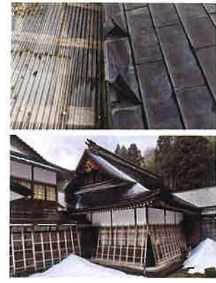
上：本堂屋根破損箇所 7月20日 下：新しい雪囲い設備 2月18日
